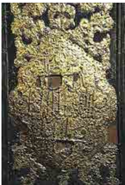
تصاویر شماره (۹ و ۱۰) کتیبه‌های مرکز لت های درب و آسیب دیدگی موجود در آن
